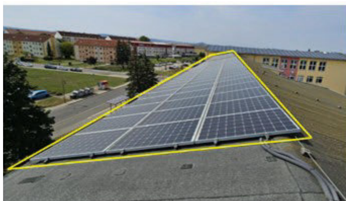
Abb. 2 – PV-Module auf dem Dach
