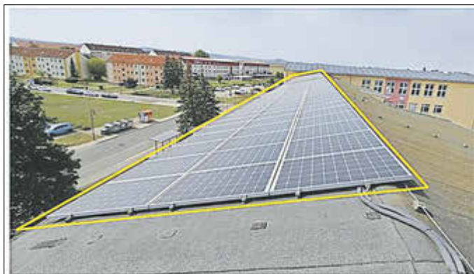
Abb. 2 – PV-Module auf dem Dach
